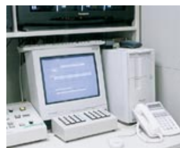
駅長事務室内のコントロール端末
