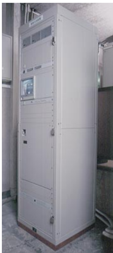
各駅に設置された画像伝送装置(LN 架)
