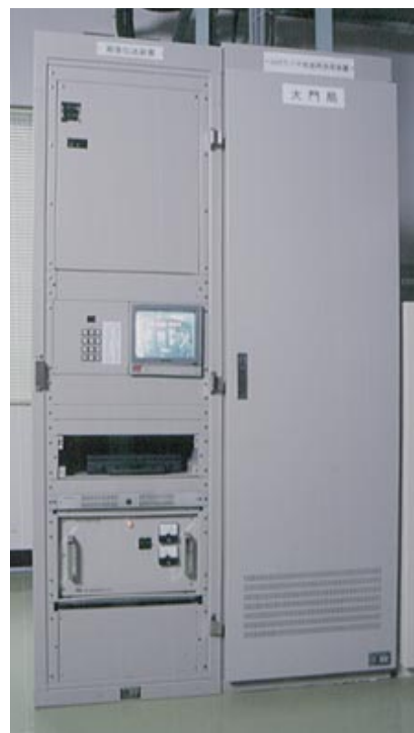
大門庁舎通信機器室に設置された画像伝送装置(CN 架)
