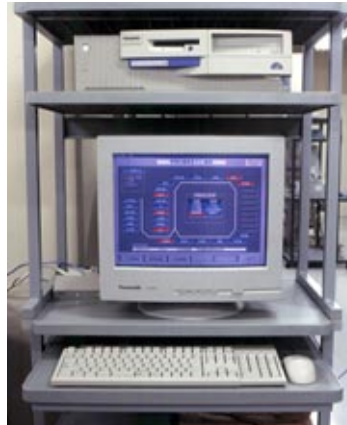
黒川運転指令室に設置された信号情報記録装置
