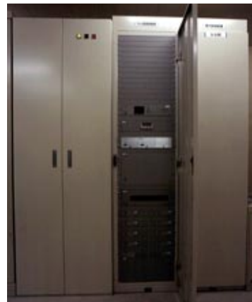
ナゴヤドーム前矢田駅の監視カメラ制御架
