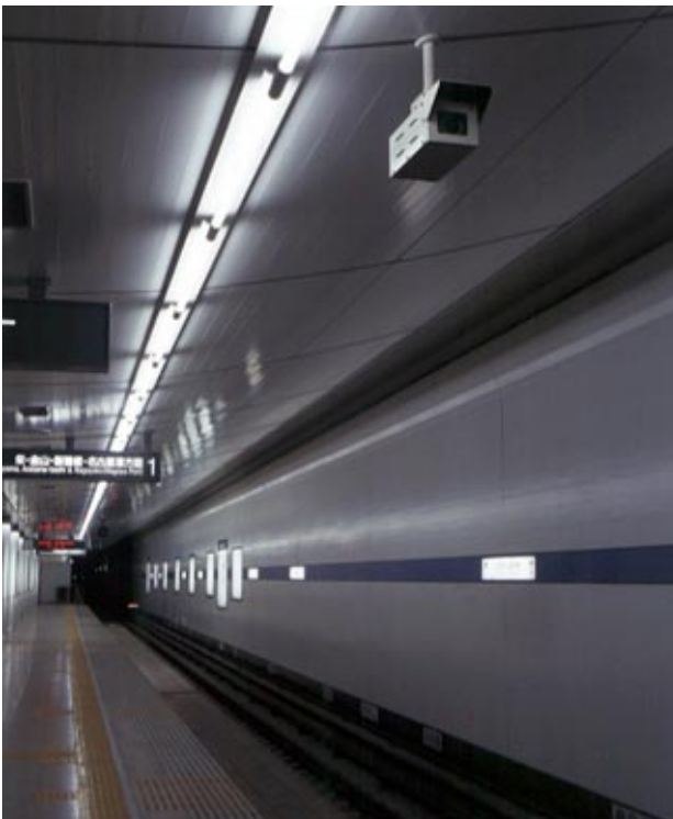
カラーテレックカメラでホームを監視
