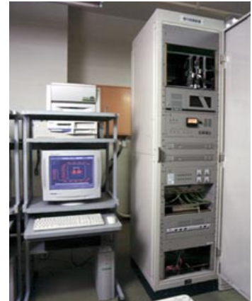
保守基地の案内制御装置・音声分析処理装置
