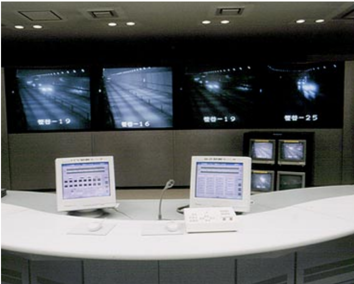
4面プロジェクターとモニターテレビでトンネル内の状況をチェック
