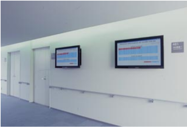
廊下の空席状況表示パネル
