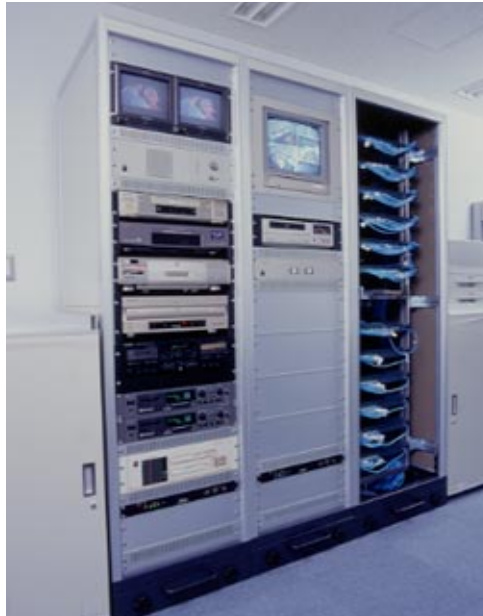
準備室の機器ラック。中央の監視モニターでは、MM1・2教室の様子を見ることができます
