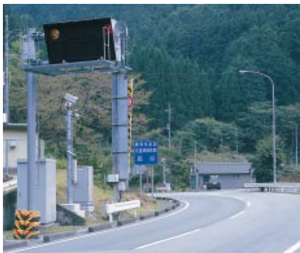
規制区間の起点と終点にはカメラとマイクを設置し、映像と音声による監視をしています
