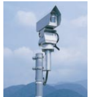
甲府工事事務所屋上に設置されたカメラ
